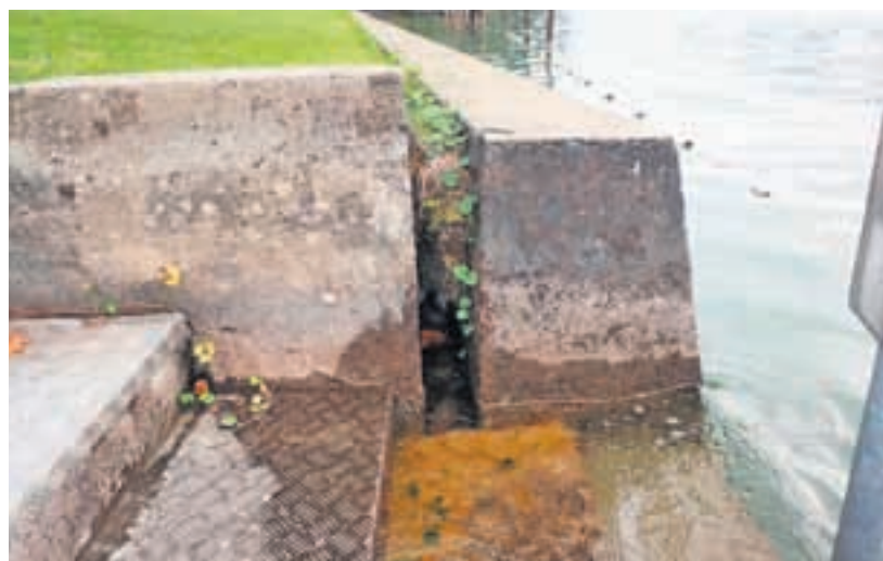
Diese Betonmauer beim Strandbad Winkel hat sich abgesenkt. Sie soll nun eine hohe Mauerkrone erhalten PD
